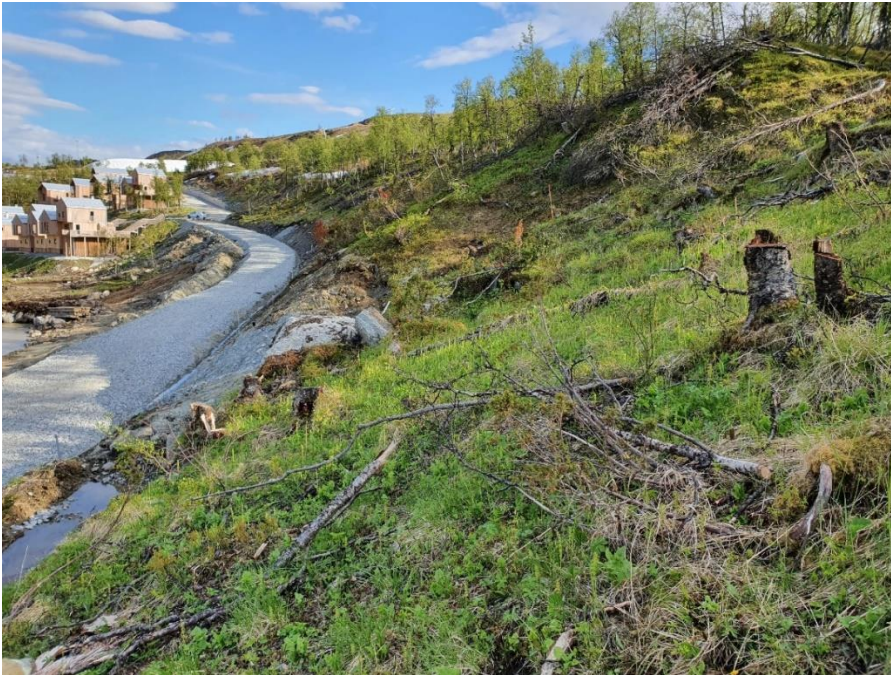
Figur 4. Brant slänt mot öst. Bebyggelse har utförts i kring släntens fot.
